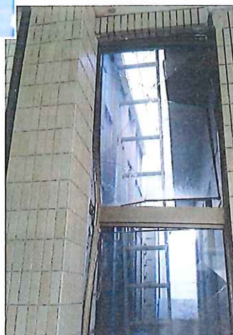
建物が土台からずれたため、サッシの枠がゆがみガラスも割れた（ケアハウス津南）
